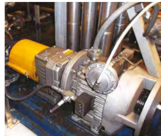
Fábrica de produtos químicos: Variador K5 com controle de velocidade pneumático remoto.
