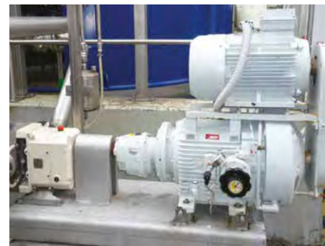
Estação de tratamento de resíduos: aplicação no exterior na bomba de lóbulo, unidade de 11 kW com motor no topo.
